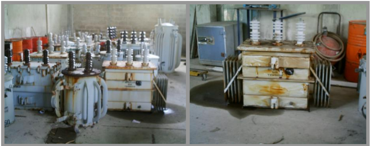
Foto 45. Transformadores Averiadados Almacenados en Instalaciones Sopesa – Bight.
